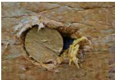
Obr. 5 - Vytrhaný otvor při zafrézování do MW
