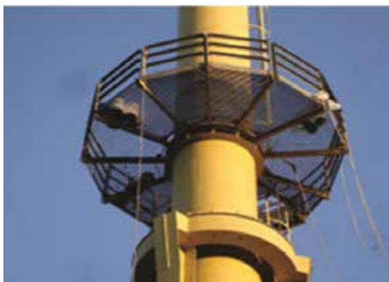
Obr. 1 - Renovace povrchu komínů (nahore původní stav komínu; dole stav komínu po aplikaci)
