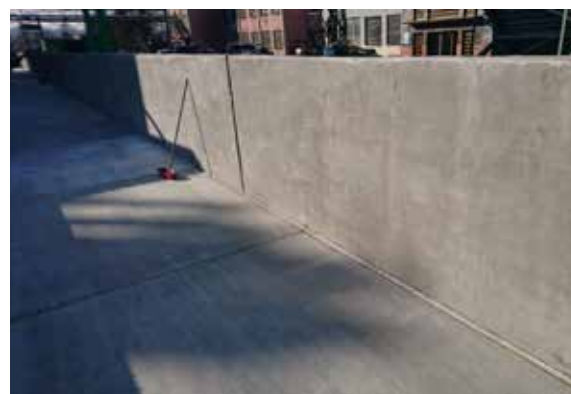
Obr. 6 - Betonová havarijní jímka na oleje, ČR
