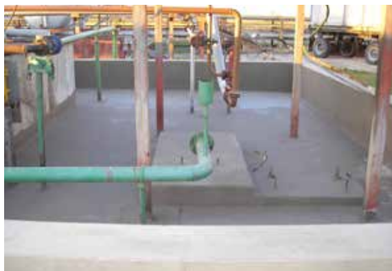
Obr. 3 - Betonová havarijní jímka na Slovensku
