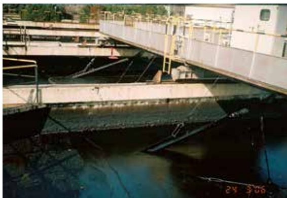
Obr. 8 - Zbytky oleje a mastnoty na povrchu betonových nádrží
