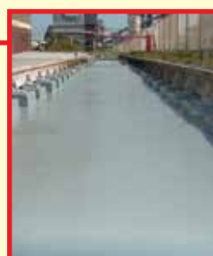
Stáčiště železničních vagonů
