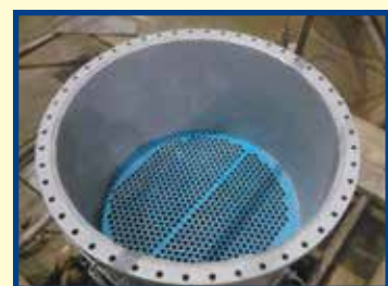
Vodní komora a trubkovnice olejového výměníku
