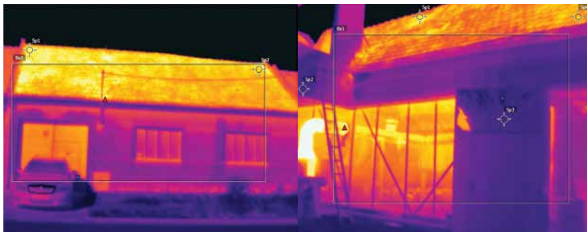
Obr. 6 - Termografický snímek sanovaného prostoru
