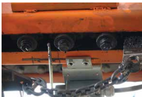
Obr. 1 - Silně znečištění dopravník vč. dráhy
