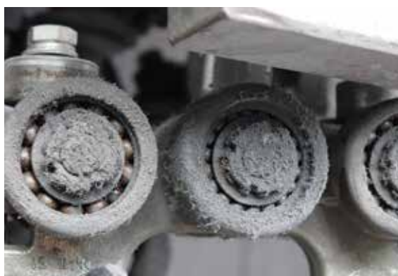
Obr. 2 - Zanesená ložiska dopravníku
