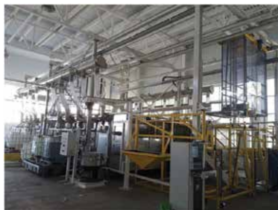
Obr. 4 - Vstupní část automatické linky
