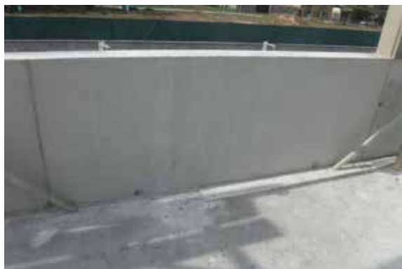
Obr. 1 – Pohledový beton dobré kvality
