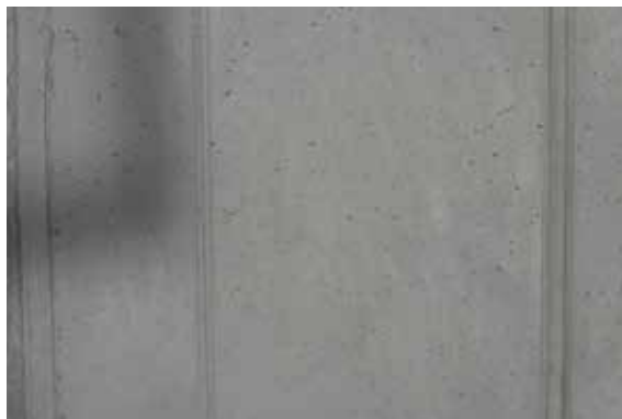
Obr. 3 – Póry v pohledovém betonu
