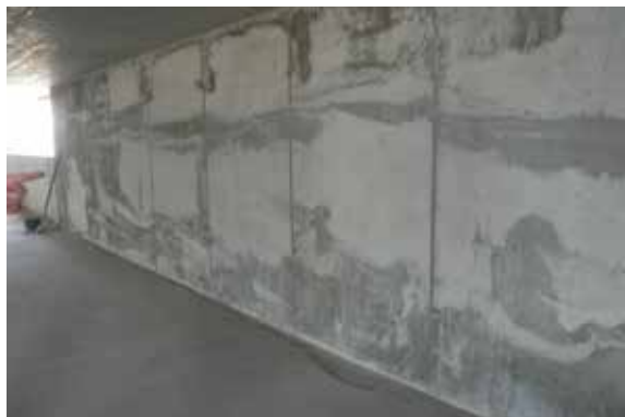
Obr. 2 – Poruchy na pohledovém betonu způsobené netěsností bednění a broušením nálitků
