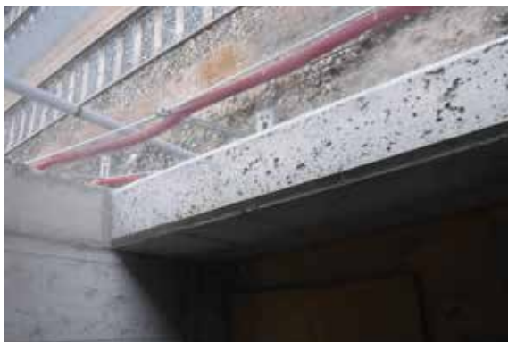
Obr. 4 – Velké póry v povrchu betonu, které mohou mít v exteriéru vliv i na trvanlivost
