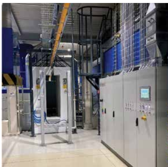
Obr. 2 - Plastová kabina a rozvádzač
