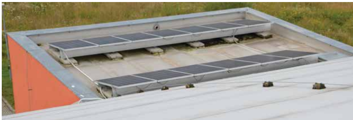
Obr. 3 – Fotovoltaické zařízení na střeše se zatěžovacími deskami
