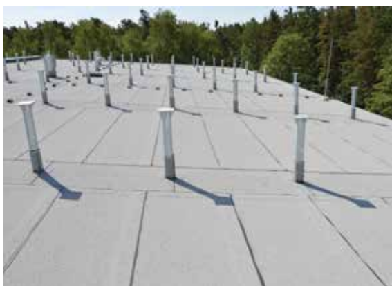
Obr. 1 – Pohled na střechu s modifikovanými asfaltovými pásy s bílým posypem, pomocné konstrukce pro montáž fotovoltaické elektrárny
