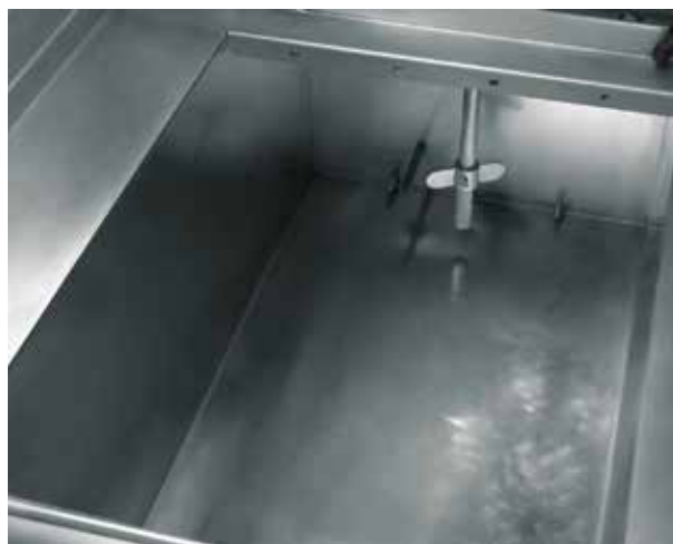
Obr. 3 – Detail odlakovací vany po vytažení koše a demontáži krytu míchadla
