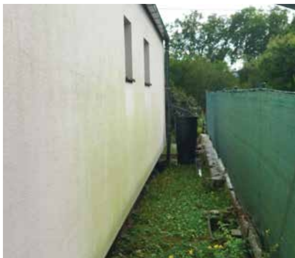
Obr. 2 – Fasáda rodinného domu s porostem mechu
