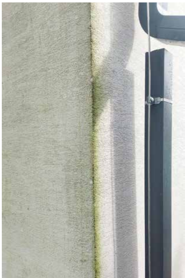
Obr. 1 – Porost mechu na fasádě rodinného domu
